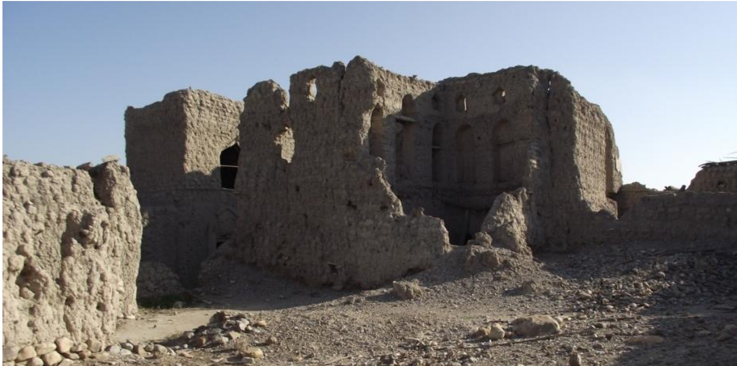
Degrado di un edificio in Adobe – Izki (Oman)
